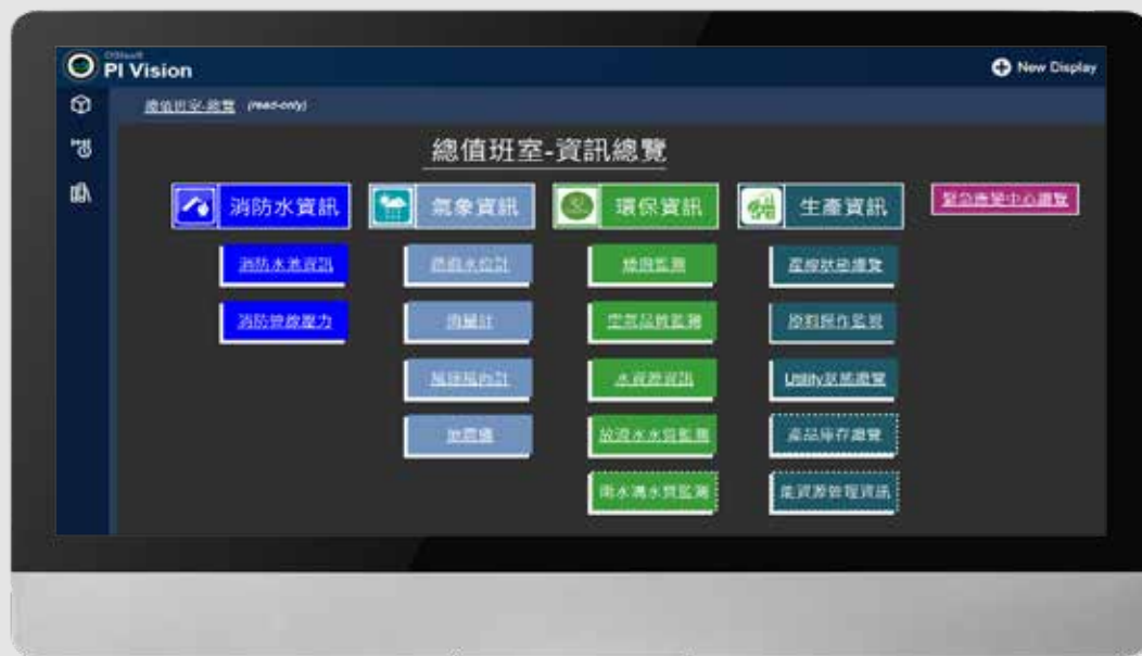
製程現場各控制室之全廠緊急應變資訊系統畫面。
